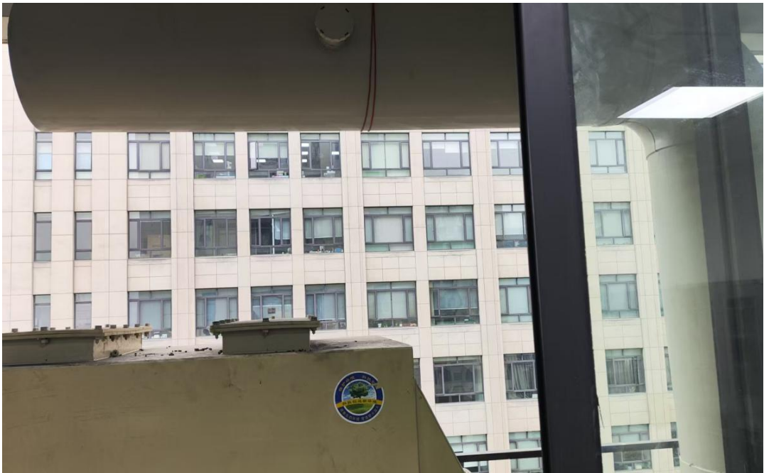
废气处理装置 DA001 现场照片
