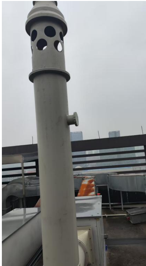
废气处理装置 DA002 现场照片
