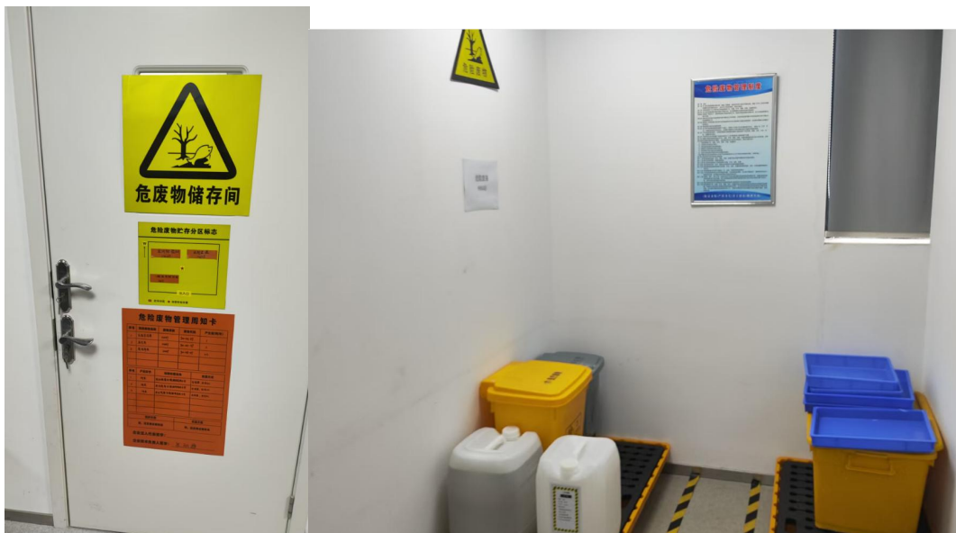
25层危废暂存间
