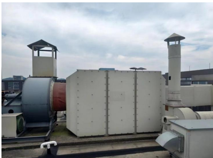
图 3-1 废气处理装置照片
