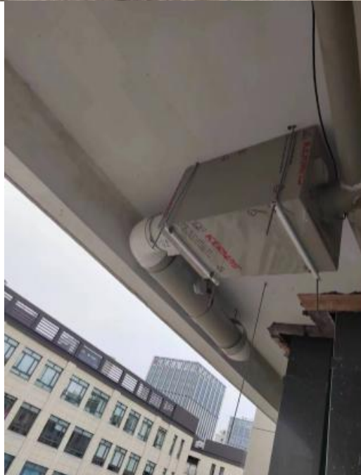
图 3-1 P1、P2 废气处理装置照片
