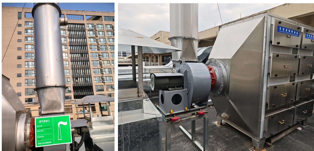
图 3-1 企业废气处理设施
